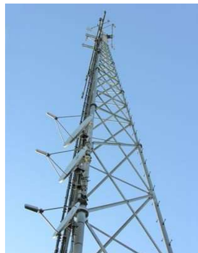
Exemplo de Estação Rádio Base do Tipo Greenfield
