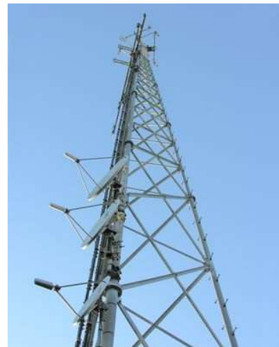
Exemplo de Estação Rádio Base do Tipo Greenfield
