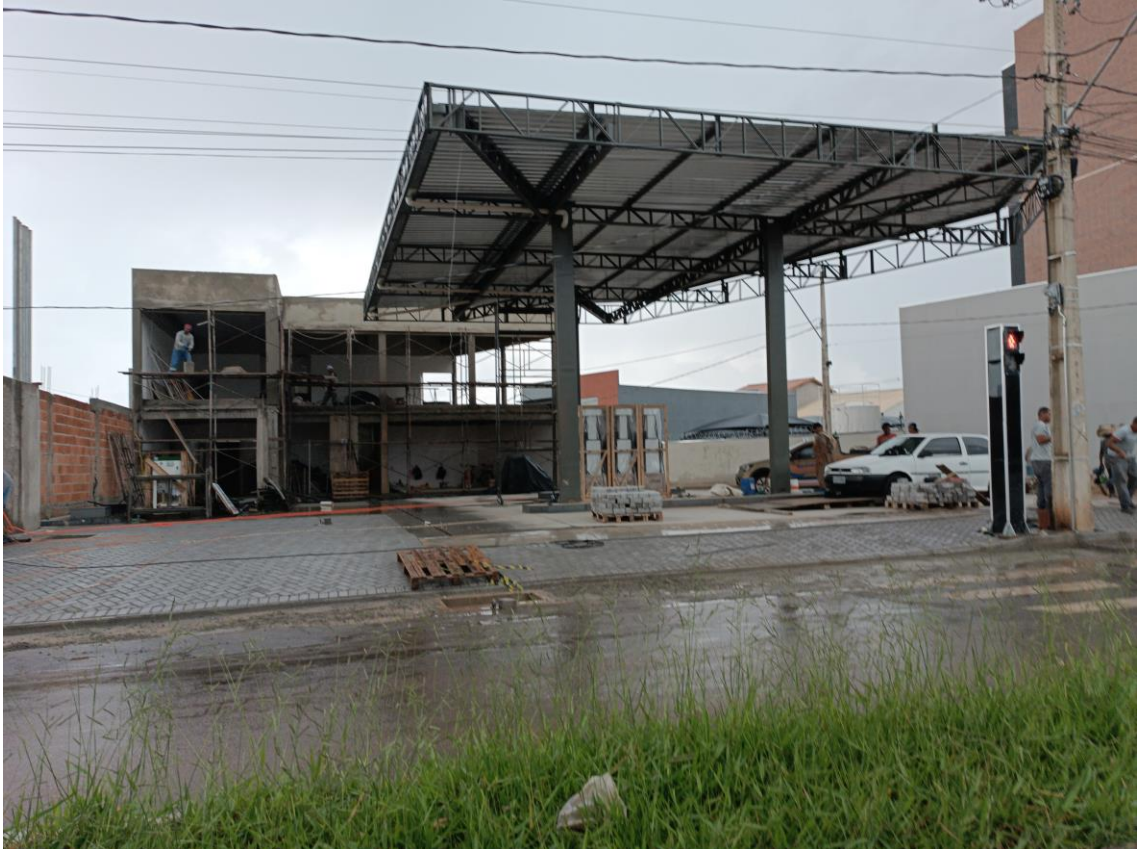
Imagem 13: Posto de combustível sendo construído no bairro Jardim das Hortências. Fonte: Do autor.
